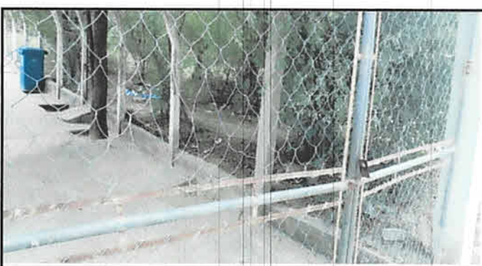
FOTO 6: EL PORTÓN Y LA PUERTA DE ACCESO SE HAN DETERIORADO, LA MALLA GALVANIZADA SE ENCUENTRA DESPRENDIDA Y SE HAN CORROIDO LOS ELEMENTOS DE FIJACIÓN.
