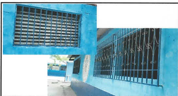
FOTO 5: LAS TRES AULAS DE LA ESCUELA Y LA BODEGA NO CUENTAN CON BUENAS VENTANAS, PUES SE HAN IMPROVISADO CON VENTANAS DE LAMINA Y SIN CORRECTO FUNCIONAMIENTO
