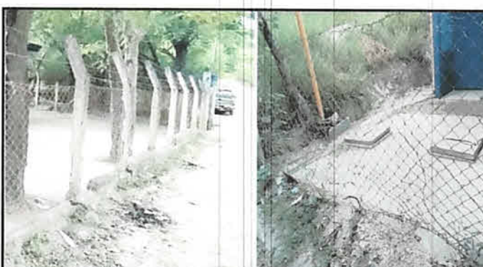
FOTO 4: LA MALLA CONTABA CON UNA BASE DE BLOCK QUE SE HA DETERIORADO, SIENDO NECESARIA LA FUNDICIÓN DE UNA BASE MAS BLOCK QUE IMPIDA EL PASO DE ANIMALES.
