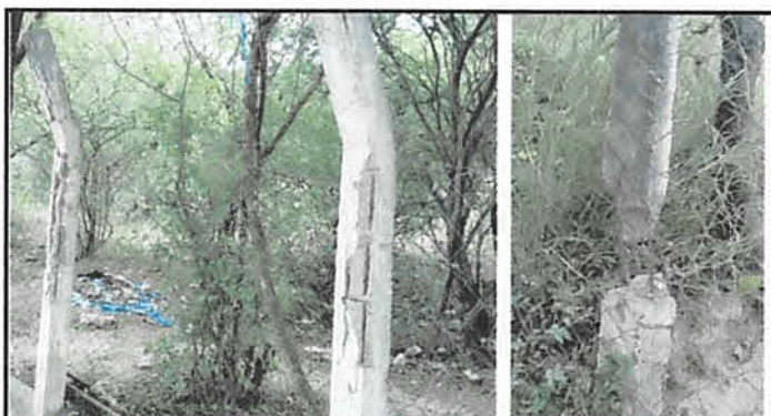
FOTO 3: LAS BASES DE SUJECIÓN DE LA MALLA EXISTENTE SON POSTES DE CONCRETO QUE SE HAN EROSIONADO CON EL PASO DEL TIEMPO Y DEL DAÑO OCASIONADO POR EL SALITRE QUE TIENEN.
