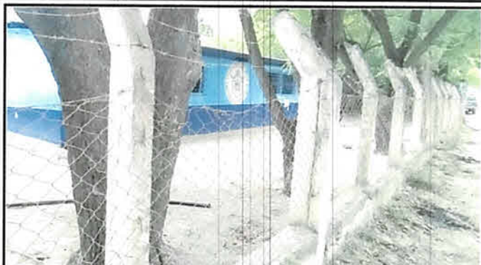
FOTO 2: LA MALLA PRESENTA AGUJEROS POR DONDE SE HAN ENCONTRADO INDICIOS QUE INGRESAN CON FACILIDAD PERSONAS AJENAS AL ESTABLECIMIENTO, EL CAMBIO DARÁ MAS SEGURIDAD.
