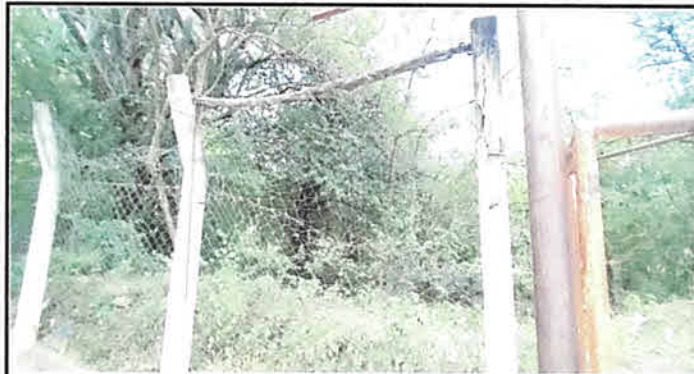
FOTO 1: LA CIRCULACIÓN FRONTAL DE LA ESCUELA ACTUALMENTE SE ENCUENTRA CON LA MALLA GALVANIZADA DETERIORADA, SE HA DESPRENDIDO DE SUS COLUMNAS Y SE HAN ESTIRADO LOS CUADROS
